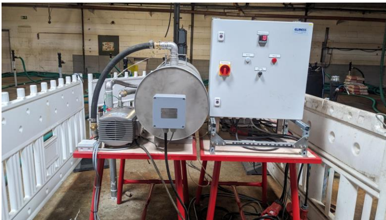
Heizregister für eine thermisch unterstützte Bodenluftabsaugung
