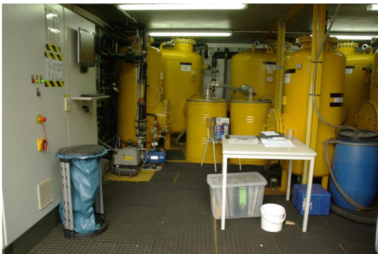
Innenansicht der Wasseraufbereitungsanlage
