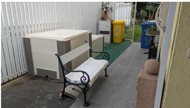
Frostsichere, schallgeschützte Pumpversuchseinrichtung auf einem Privat-Gelände (2023)
