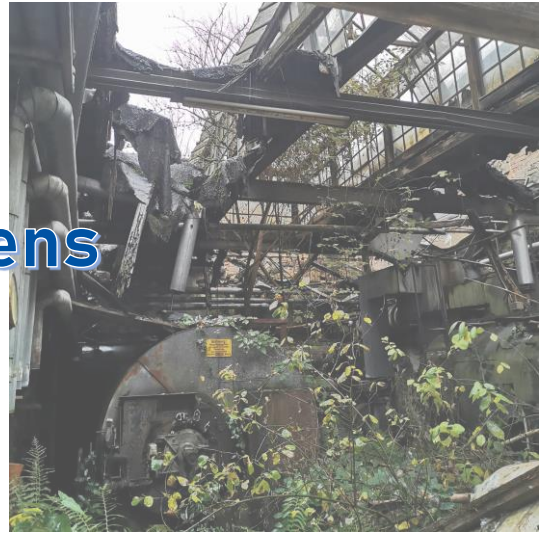
Blick in das verfallene Kesselhaus
