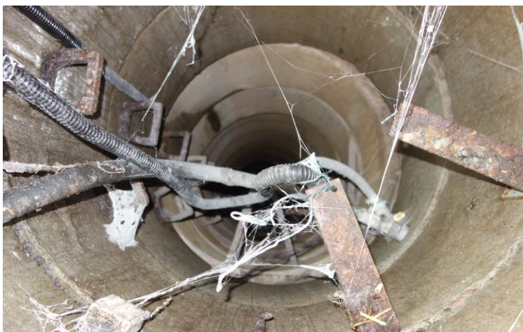
GW-Monitoring an einem stillgelegten Notbrunnen der Stadt Maintal
