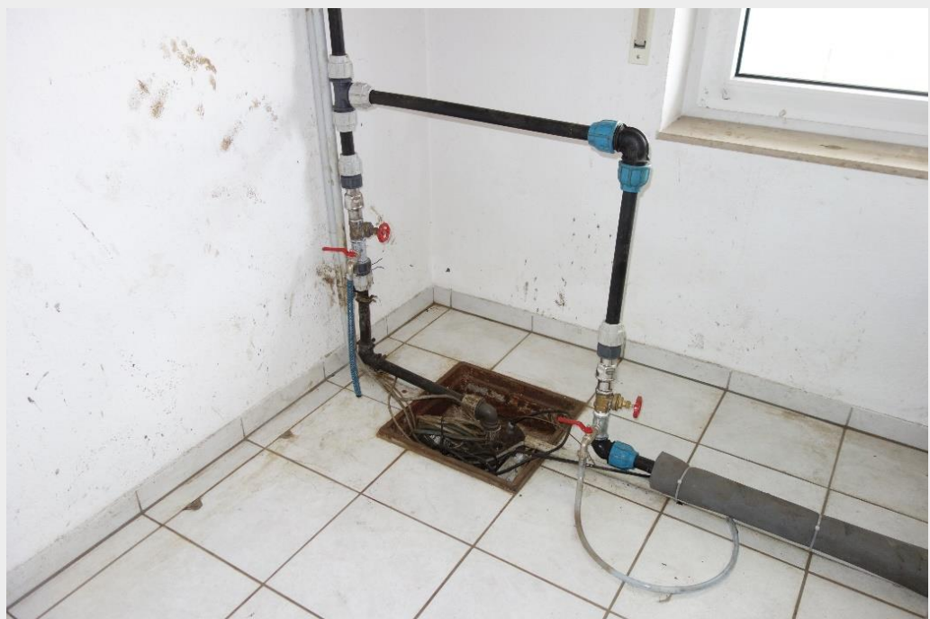
GW-Fördereinrichtungen im unbewohnten Untergeschoss des Wohnhauses auf dem Projektstandort (2022)
