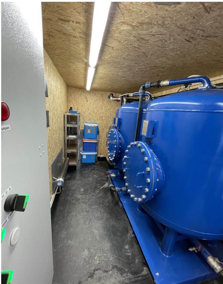
Wasseraufbereitungsanlage von innen
