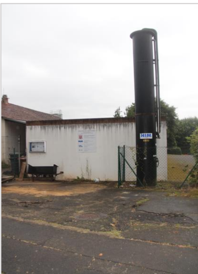
Grundwasserreinigungsanlage in einer Fertiggerade auf dem Bauhof der Stadt Büdingen
