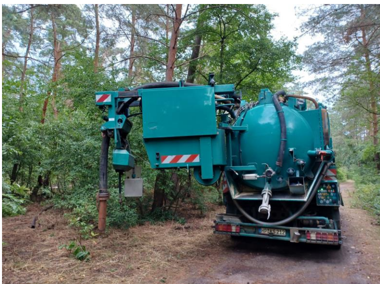
Regenerierung der Infiltrationsbrunnen
