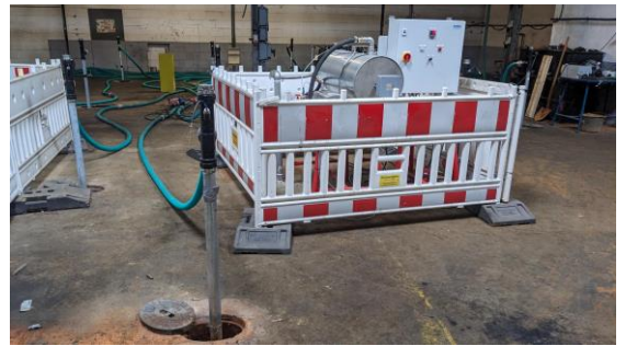
Heizregister für eine thermisch unterstützte Bodenluftabsaugung innerhalb eines Absaugfeldes
