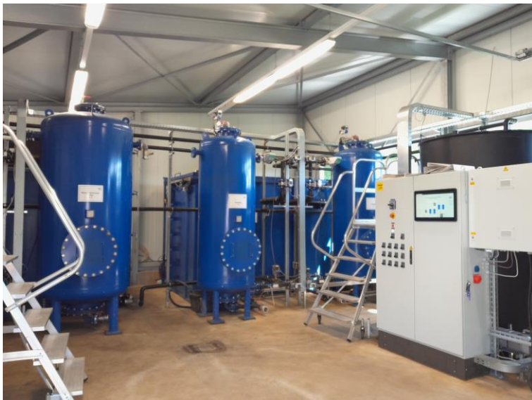
Wasseraufbereitungsanlage mit Fernwartungssystem
