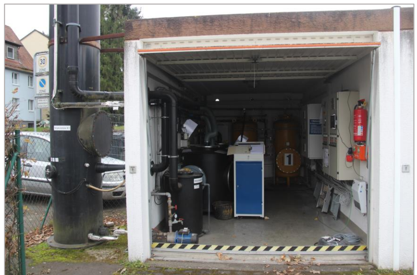
Innenansicht der Grundwasserreinigungsanlage
