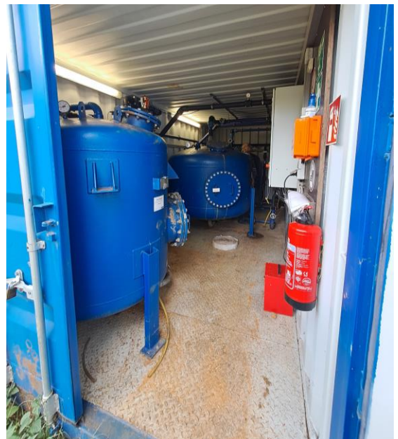
Grundwassersanierungsanlage von innen
